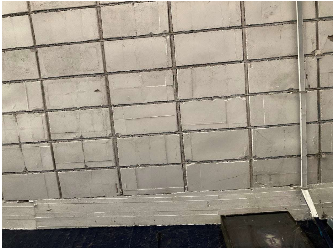
IMAGEN 7 – ESTADO GENERAL DE LAS PLACAS
