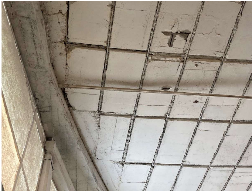
IMAGEN 8 – HUMEDAD EN PLACAS DE LA CUBIERTA
