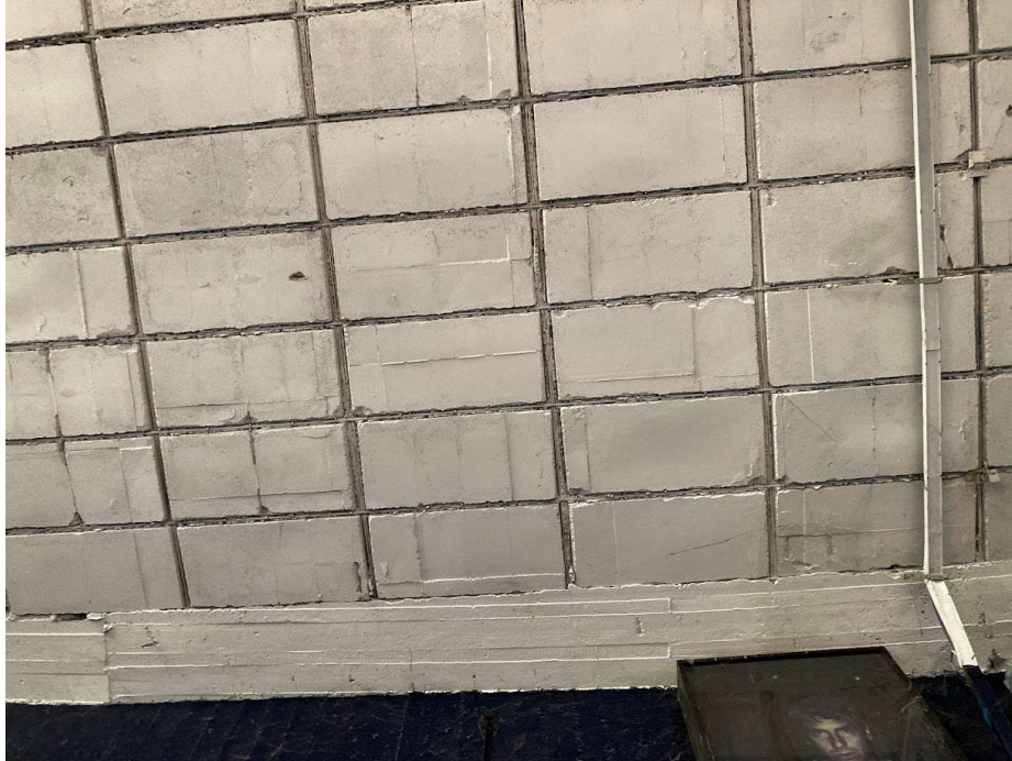
IMAGEN 3 – DETALLE DE PLACAS PREMOLDEADAS
