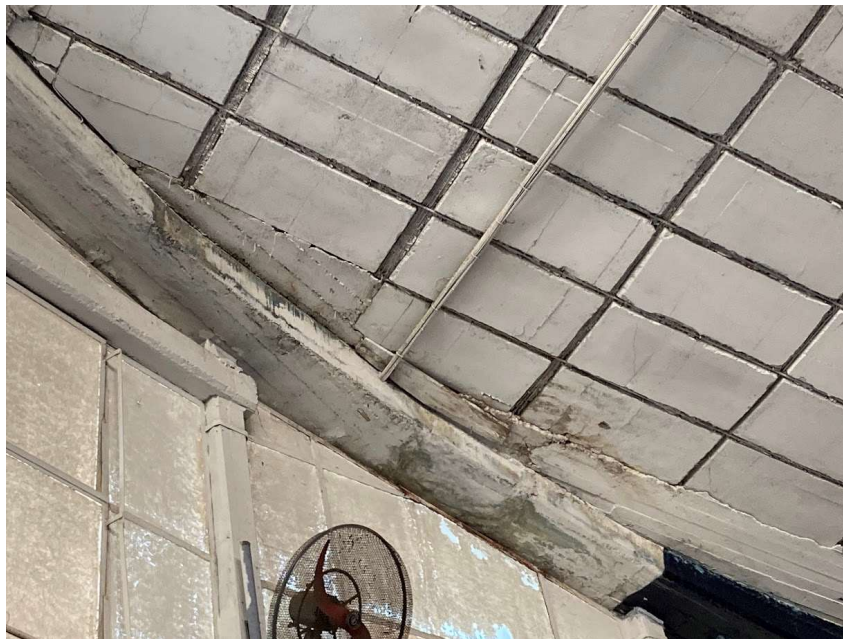
IMAGEN 9 – HUMEDAD EN PLACAS DE LA CUBIERTA
