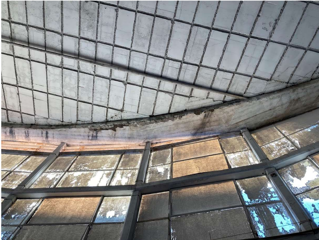
IMAGEN 10 – ARCO CON DAÑOS POR INGRESO DE AGUA DE LLUVIA
