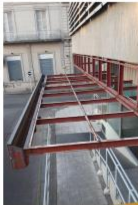
Imagen 15: Estructura metálica sobre fachadas deteriorada.
